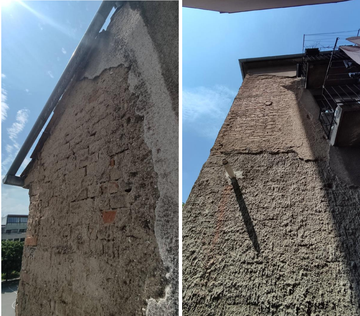
Fotografija 7 i 8 – Prikaz dotrajale vanjske obloge zgrade te vidljivost unutarnje građe
